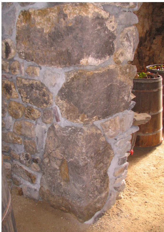
Slika 221: Izredno masivni vogalniki predelne stene v sredini kleti Petričkave hiše, verjetno pozidani kasneje in prenešeni iz katerega bolj statično kočljivega, a predelanega dela stene.
