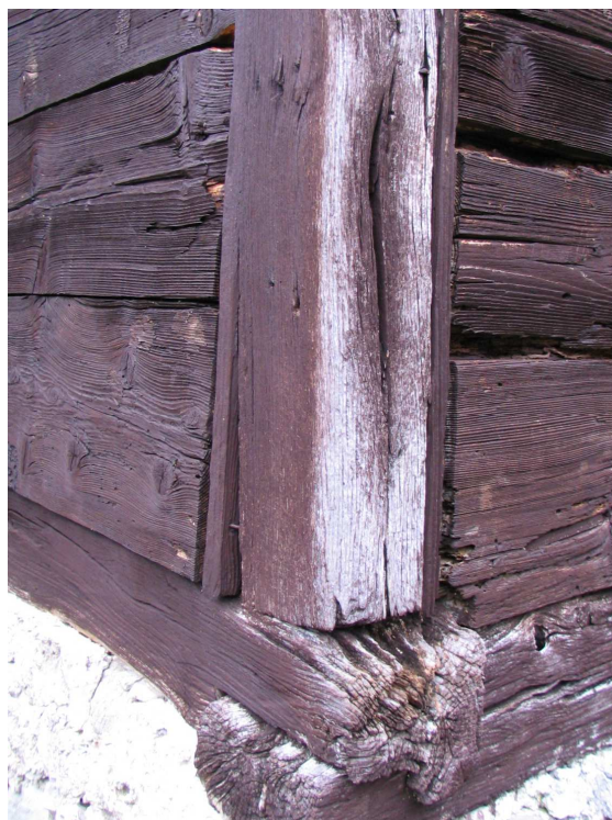
Slika 98: Nezaščitena konstrukcija sten v zgornjem delu ključa. Hrastov podložni okvir na kamnitem zidu, vertikalne hrastove grede in polnila iz pribl. 10 cm debelih žaganih gred, vloženi v utor vertikalne.
