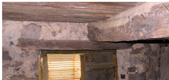
Slika 95: Zgoraj obokana preklada nad vrati v štal, iz 18. ali začetka 19. stoletja, spodaj statično manj ustrezna preklada nad vrati v klet, z letnico 1908.
