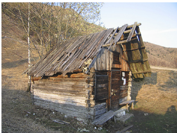
Slika 2. Ko streha lesene stavbe popusti, le-ta zelo hitro propade (foto: M. Humar).
