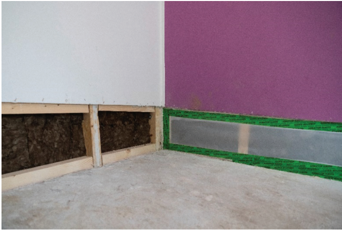
Slika 9. Prikaz vzpostavitve zrakotesne ravnine, s katero mora biti sklenjen celoten ovaj hiše, september 2023.
