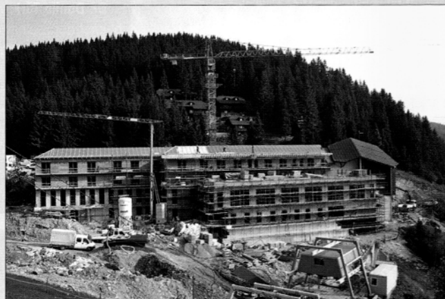
Trenutno dela na objektu vsak dan okoli 140 delavcev različnih izvajalskih in podizvajalskih podjetij (foto: Benjamin Kanjir)
