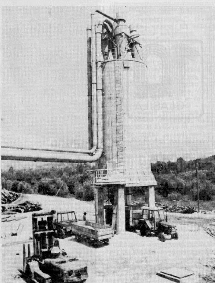
Silos za odpadke — TO Podnart
