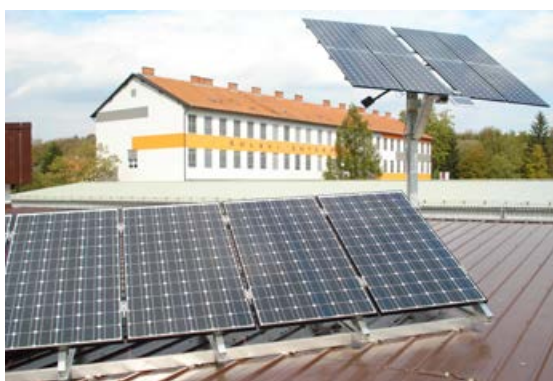
Slika 111: Fotonapetostna elektrarna; Šolski center Ptuj, arhiv OVEN Elektro Maribor
