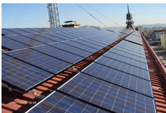
Slika 110: Fotonapetostna elektrarna; Elektro Maribor, Vetrinjska ulica 2, Maribor, arhiv OVEN Elektro Maribor
