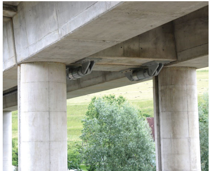
Slika 10. Med okvirji so vgrajene hidravlične naprave za prenos udarnih sil STU 2500 kN (foto: Ponting, d. o. o.).
