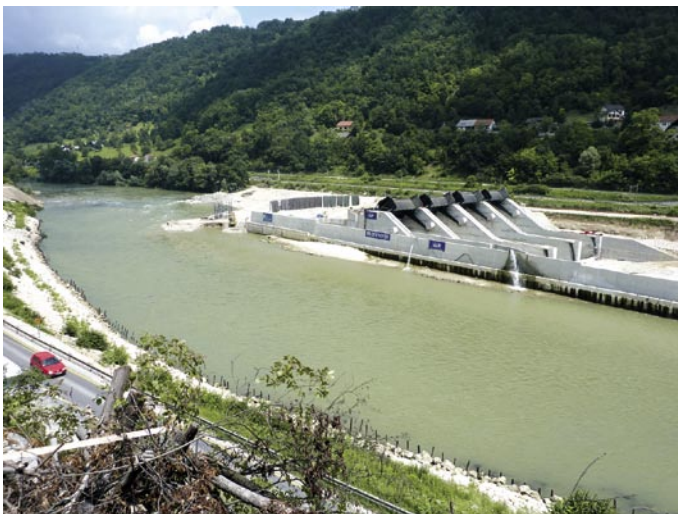
Slika 6 • Zaključena dela v I. gradbeni jami HE Krško; zgrajena so 4 prelivna polja in križna zidova na levem bregu Save; stanje na 3. julij 2009
