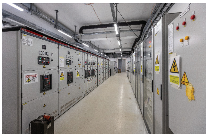
Slika 9. Elektroomare v elektroobjektu, junij 2023.
