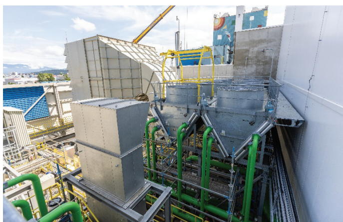
Slika 10. Tehnološka oprema in napeljave na strehi zgradbe plinskih turbin, avgust 2023.
