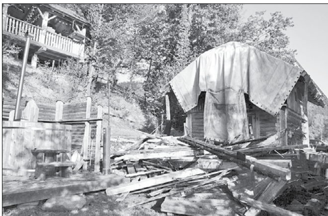
Polovica objekta je popolnoma uničena, tudi drugi del bo potreben prenove in zamenjave kritine. (Foto: Štefka Sem)
