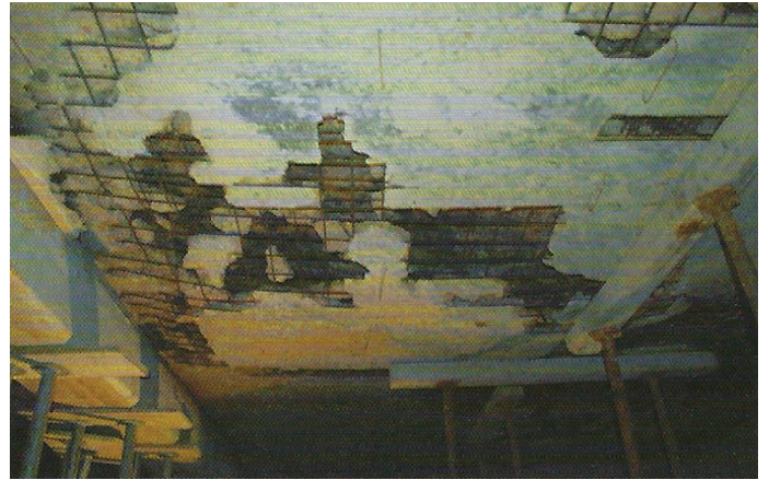
Slika 2. Poškodbe stropne plošče prizadetega dela kleti jeseniške stavbe [Kolšek, 2017].
