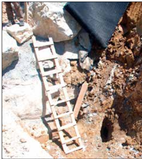
Kraška kaverna, odkrita pri izkopu za temelje ceste, 20. 5. 2010.
