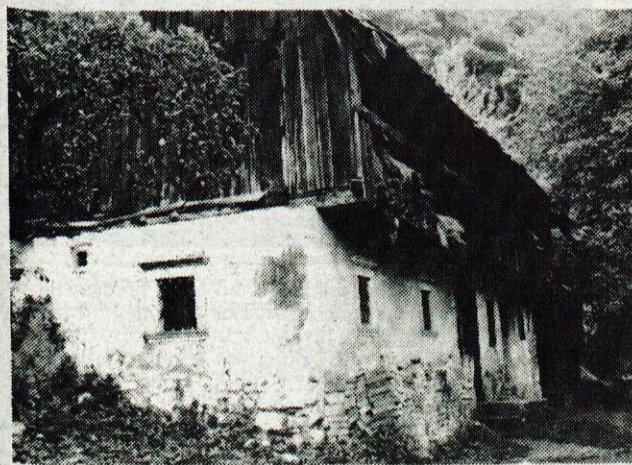
Hiša, ki to ni več - Hiša Šolarjevih ne bo vzdržala letošnje zime, saj se streha nevarno nagiba in vsepovsod pušča. Tudi "ganka" je samo še za vzorec... Foto: D.Sedej
