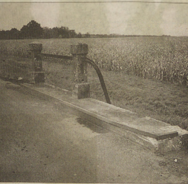
Cesta, ki povezuje Turnišče z Genterovci, je prav gotovo cesta z največjim številom mostov. Stanje ceste in mostov pa je iz leta v leto slabše. Most na Ledavi, ki ga »sanirajo« (zapolnijo luknje) vsakih nekaj mesecev, pa je sploh zgodba zase. Tudi ograja, ki je bila poškodovana v prometni nesreči, na enem od številnih mostov je še naprej vse drugo kot ograja. Še sreča, da po omenjeni cesti ne poteka težji tovorni promet, sicer bi bilo stanje cest in mostov še klavrnejše. Vse nanizano kliče k popravilu, sicer se lahko zgodi še več nesreč, ki bodo nastale iz objektivnih razlogov. - Fotografija: J. Žalik
