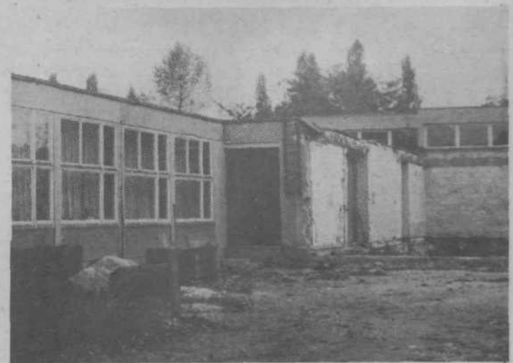
SANIRANJE VVZ ANGELCE OCEPEK - Najbolj poškodovani del stavbe je porušen - to je prva faza sanacijskih del na poškodovanem poslopju vrtca Angelce Ocepek. V drugi fazi bodo popravili poškodovani obstoječi del stavbe z okrepitvijo temeljev, sten, centralnih sanitarij, inštalacij itd. Ta dela bodo končana do konca leta. Za tretjo fazo je v načrtu gradnja novega dela stavbe, ki je sedaj porušena. Pričetek del bo mogoč, ko bodo zagotovljena sredstva. Od 800 starih milijonov, kolikor bo stala celotna sanacija, manjka še 150 starih milijonov. (Foto: S. G.)
