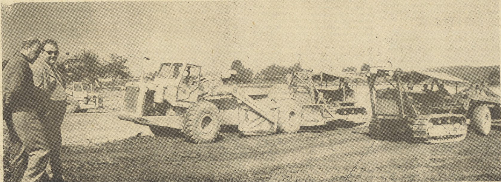
Tehnični direktor tov. ing. Jože Uršič in tov. Edo Kragelj si ogledujeta mehanizacijo pred ograditvijo gradbišča Jesenice
