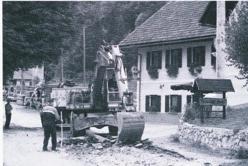
Septembra so na Medvedjem Brdu pričeli obnavljati cestišče, ki so ga poškodovale med polaganjem vodovodnih cevi. /Foto: P.T./
