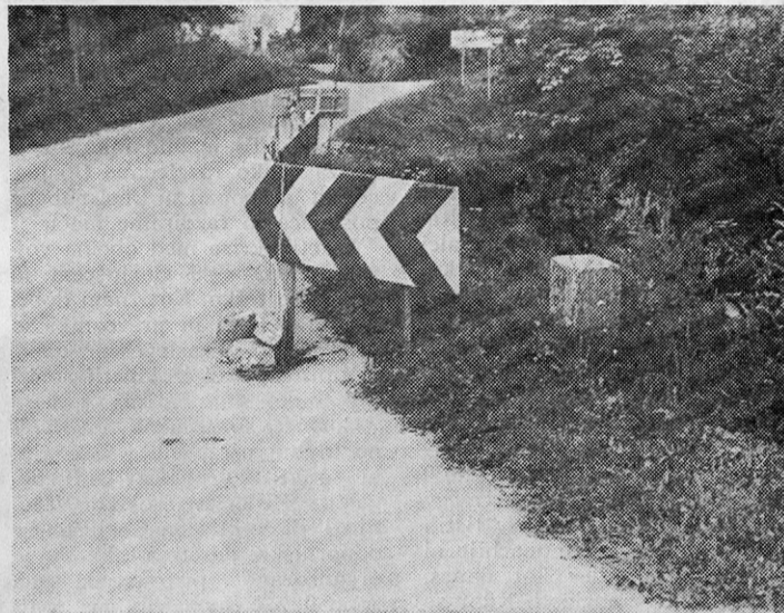
Spodnje Gorje, na Fortuni: Že lani v septembru se je na Fortuni odtrgal pod cesto zemeljski plaz. Ista situacija je še danes. Obstoji nevarnost, da se bo cesta na tem odseku še pogrezala, če ne bodo kaj ukrenili in jo popravili. Tako pa je postavljena tam le smerna tabla.
