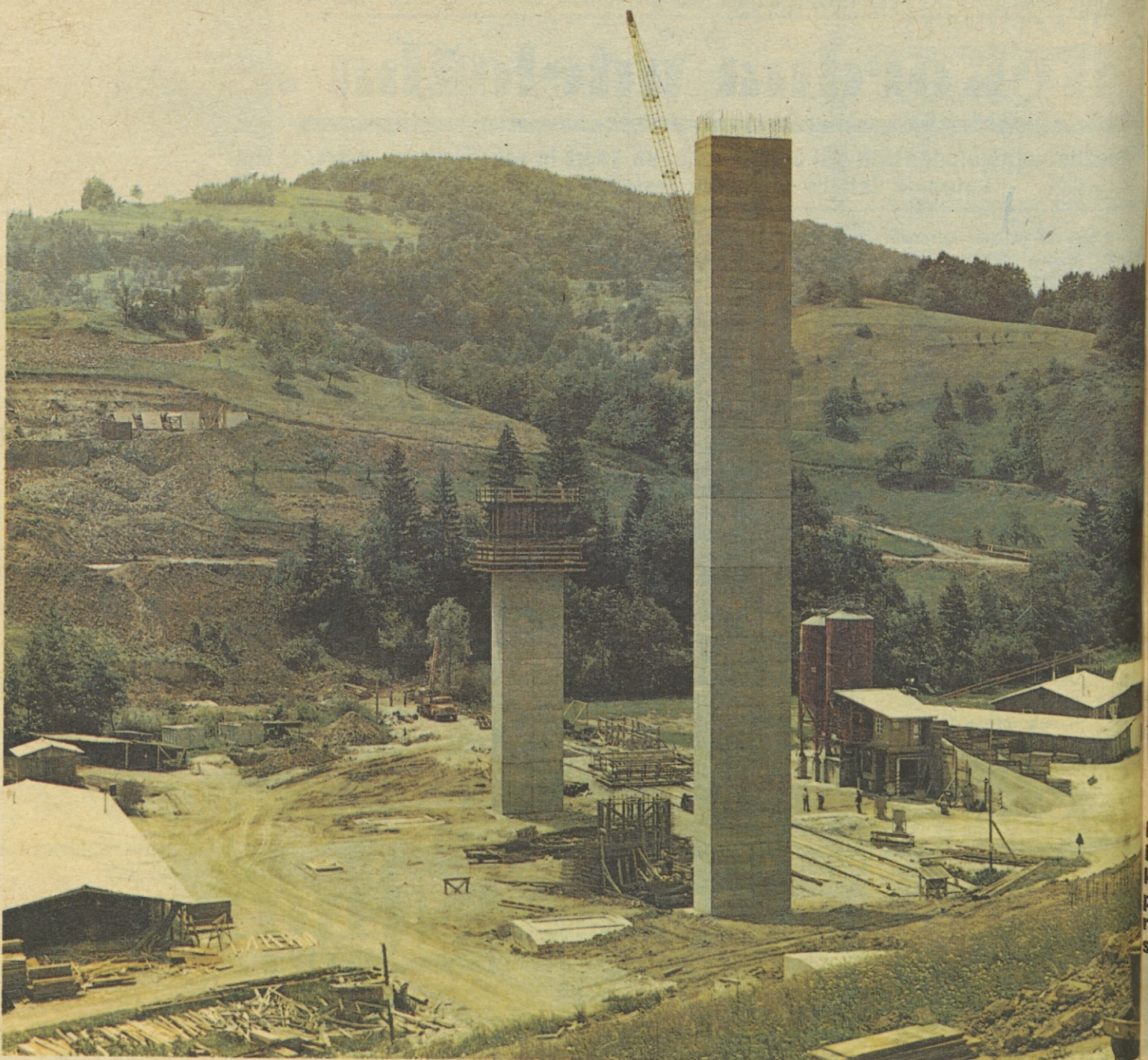
Na odseku avtomobilske ceste med Hočami in Levcem je tudi šest večjih viaduktov, ki jih gradi Gradis iz Maribora in Raven. Skupna dolžina vseh šestih je 2360 metrov. Najdaljši je viadukt Preloge, ki meri 560 metrov. Na fotografiji pa je začetna faza gradnje viadukta Škedenj II, ki je zanimiv po tem, da bosta dva stebra visoka kar 50 metrov. V primerjavi z našim doslej najvišjim viaduktom Peračičo bosta Škedenj II le 20 metrov nižji. – FOTO: A. AGNIČ
