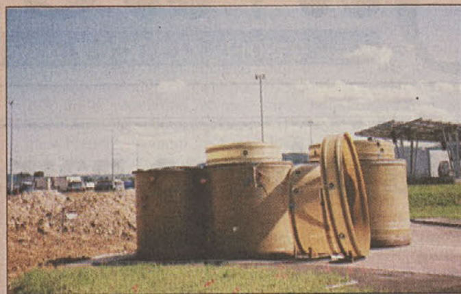
Obrežje: kdaj do čistilne naprave?
