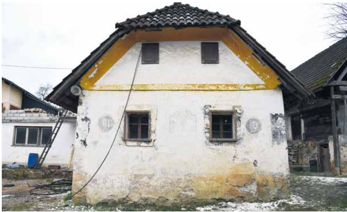
Vzhodna fasada hiše s poslikavo sv. Florjana, šivanim robom in starimi poslikavami (foto: M. Pergar).
