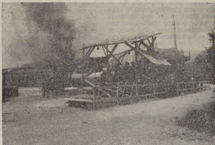
ASFALTER V RIBNICI dela s polno paro že nekaj časa. Iz velikanskega stroja blizu Kovinskega podjetja se po vse dni vali gost, zadržljiv dim, kamioni pa komaj sproti odvažajo namešani asfalt na novo cestišče. Cesto so začeli asfaltirati na odseku od Ortneka proti Dvorski vasi in sedaj je že gotovih okrog tri kilometre ceste...
