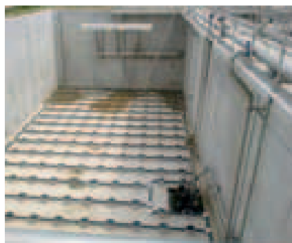
CCN Vrhnika – prežračevala v bazenu
