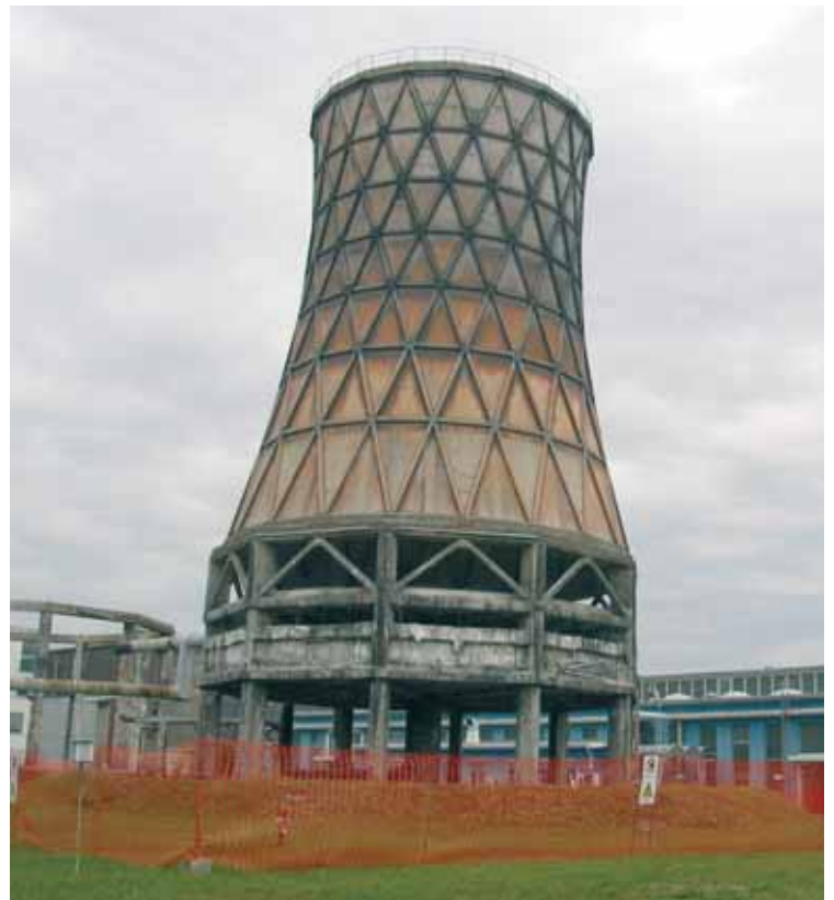
Hladilni stolp pred sanacijo
