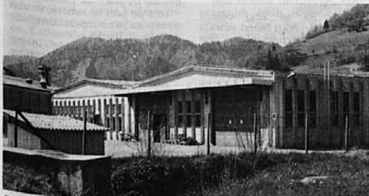
Streho bo treba popraviti tudi na skladišni hali
