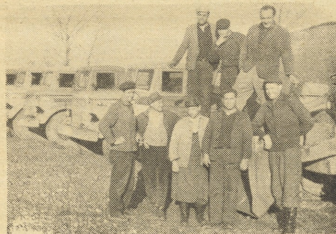
Da, to so naši pridni šoferji. V rekordnem času so na gradbišču Kidričevo naložili in prevozili na razdaljo 4 km 45.000 m 2 zemlje in pripeljali 10.000 m 2 gramoza
