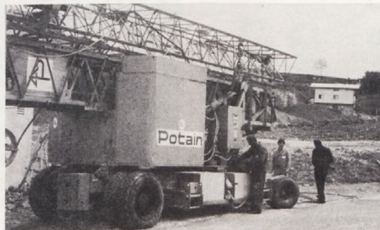
Premični žerjav na gumijastih kolesih francoske izdelave, ki ga vidite na gornji sliki na gradbišču sektorja Novo mesto na Ragovski v Novem mestu, je zaradi svoje premičnosti izredno uporaben
