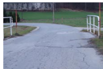
Poškodbe na cesti Košarjak–Müže
