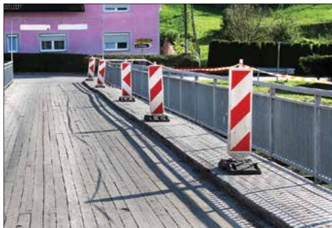
Zaradi nevarnih poškodb je hodnik za pešce do nadaljnega zaprt.
