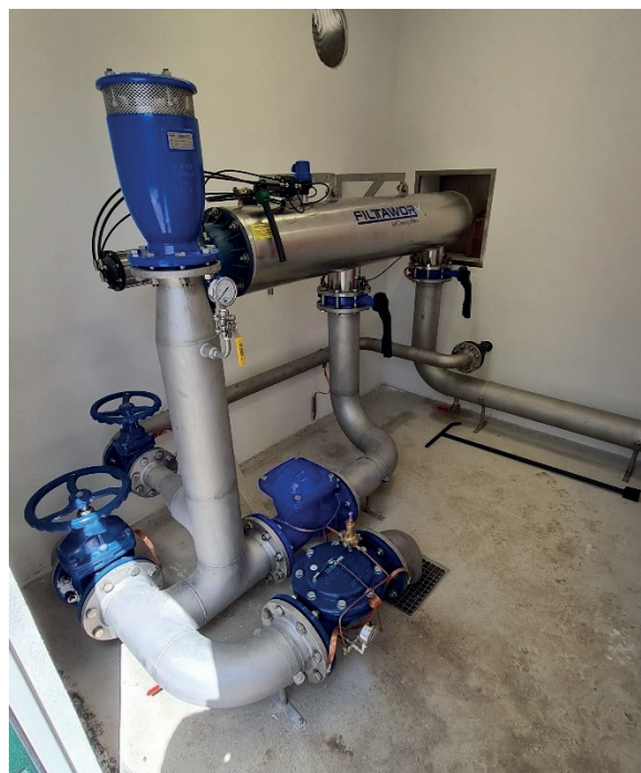
Notranjost črpališča s samočistilnim filtrom (Foto: B. Naglič)
