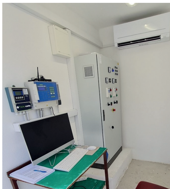
Notranjost črpališča z elektro omaro, merilcem pretoka vode, krmilnikom namakanja in črpalke ter računalniško opremo (Foto: B. Naglič)
