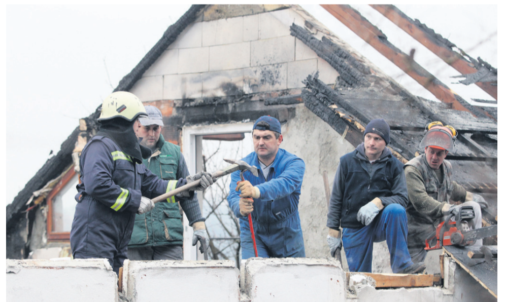
Krajani so Kuder-Zdolškovim priskočili na pomoč takoj po požaru. Osrednja čistilna akcija je bila v soboto, ko so domači gasilci in sosedi počistili pogorišče. Požar je v sredo gasilo 45 gasilcev prostovoljnih gasilskih društev Levce, Gotovlje, Petrovče, Ponikva pri Žalcu, Žalec, Zavrh nad Galicijo in Velika Pirešica.
