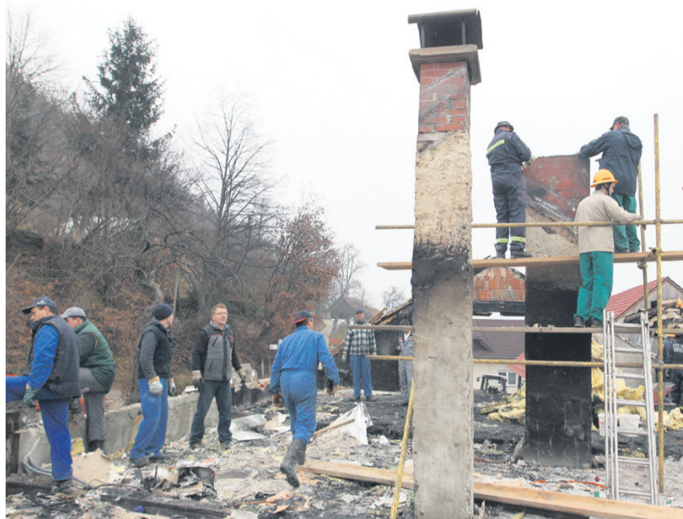
Požar je popolnoma uničil zgornji del hiše, od katerega ni ostalo popolnoma nič. Po prvih ocenah je nastalo za približno 60 tisoč evrov škode, a kot zatrjujejo v krajevni skupnosti, bo škode bistveno več.
