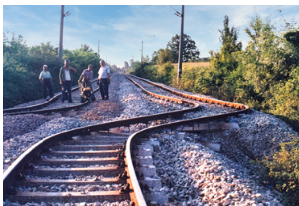
Slika 7: Močno zviti tiri železniške proge zaradi prelomnega pretrga potresa Kocaeli v zahodni Turčiji leta 1999 (vir: www.koeri.boun.edu.tr )
