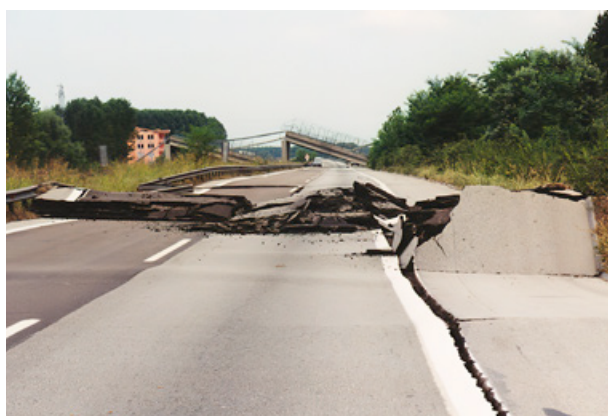
Slika 6: Hude poškodbe ceste in porušitev nadvoza zaradi do 5,7 m velikih vodoravnih premikov ob prelomnem pretrgu potresa Kocaeli v zahodni Turčiji leta 1999 (vir: www.koeri.boun.edu.tr )
