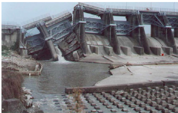
Slika 9: Vodna pregrada Ši-Kang na Tajvanu, ki se je delno porušila ob potresu Chi-Chi leta 1999 (vir: Wieland in Fan, 2004)
