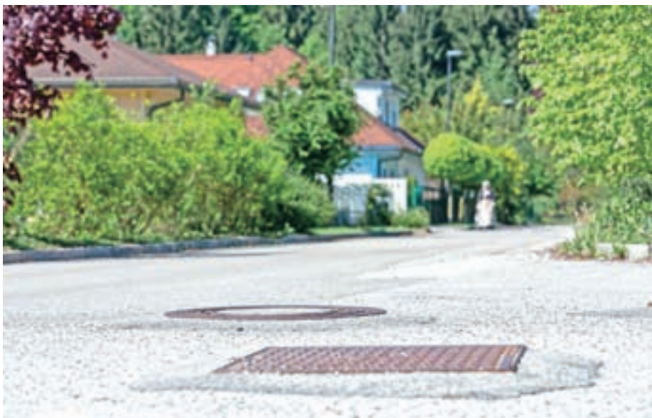
Zaključna plast finega asfalta na Zbiljski cesti še ni položena, jaški so dvignjeni in velik problem je to še posebej pozimi pri pluženju. / Foto: Peter Košenina
