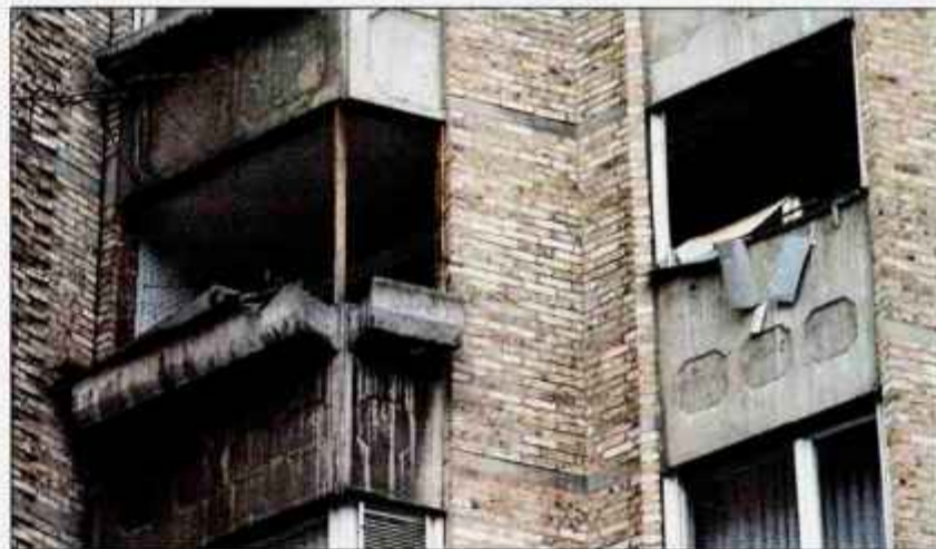
Stanovanje na Gregorčičevi 11 a v Ljubljani je pravo gnojišče. / Foto: Goran Ravčič
