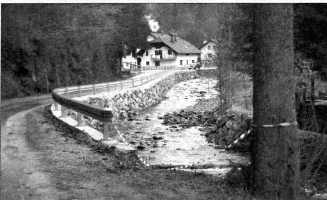
Odsek na cesti Mozirje-Lepa Njiva kljub zaključku sanacije domačini smatrajo za nevaren (foto: Ciril M. Sem)
