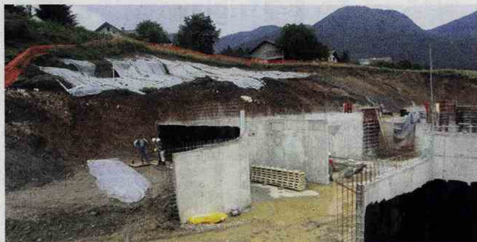
Plaz so sprožili nezaščiteni posegi v zemljišče. V ljubljanskem Gradisu so v petek za nivozgrajenimi kletnimi zidovi izvedli ustrezne zaslize zemljine, kar preprečuje nadaljnje sprožanje plazju.
