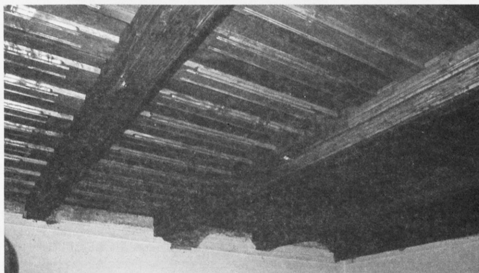
Po analogijah izdelan nov lesen tramovni strop v prvem nadstropju. Arhiv ZVKDS, OE Novo mesto
