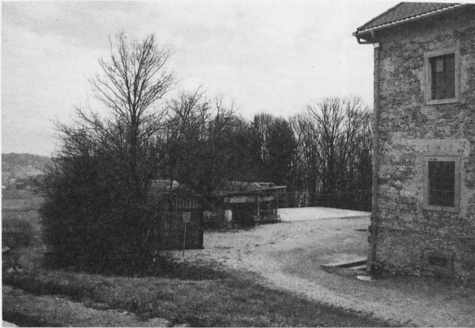
Pogled na porušeno gospodarsko poslopje ob graščini – to bi veljalo v prihodnosti ponovno pozidati. Arhiv ZVKDS, OE Novo mesto
