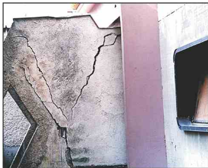
Razpoke na lokalu so ogromne, okna pa kljub stalnim zaščitam nenehno odprta. Tako kar vabijo nepridiprave.
