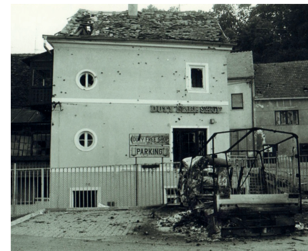
Poškodovani objekti pri MP Gornja Radgona (Foto: Jože Pojbič)
