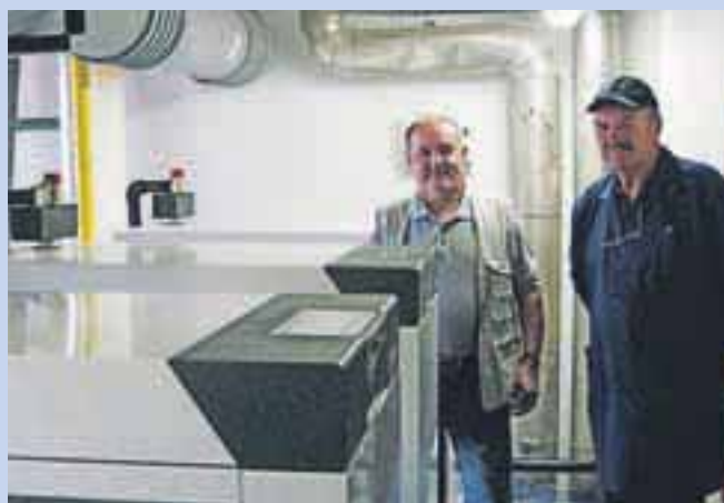
Ivan Šantl (levo) in Željko Domjanič v prenovljeni kotlovnici na Škofjeloški cesti.
