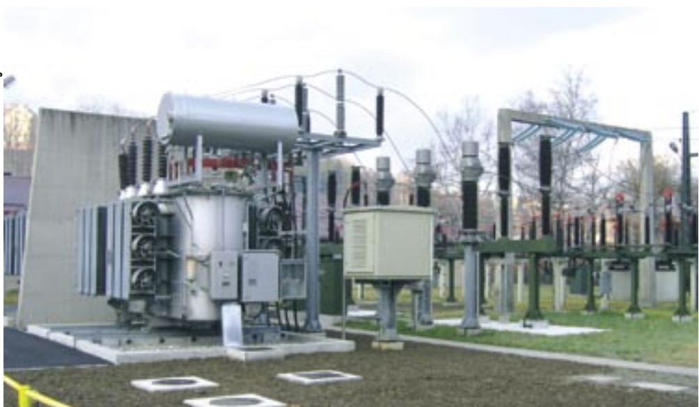
110 kV stikališče s TR I 110/20 kV in TR II 110/10 kV.
