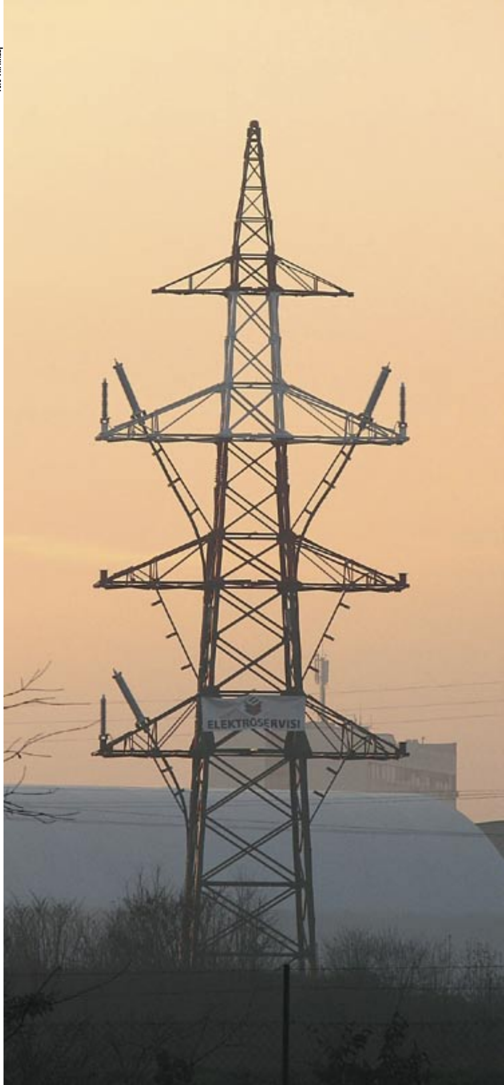
Kabelski končniki na 110 kV daljnovidnem steburu.
