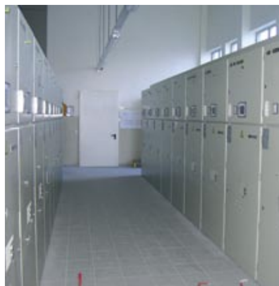
Slika 4: Novo stikališče 20 kV.
