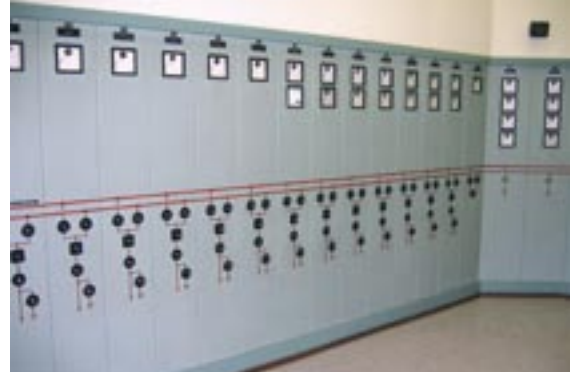
Slika 1: Obstoječi komandni prostor stikališča 10 kV.
