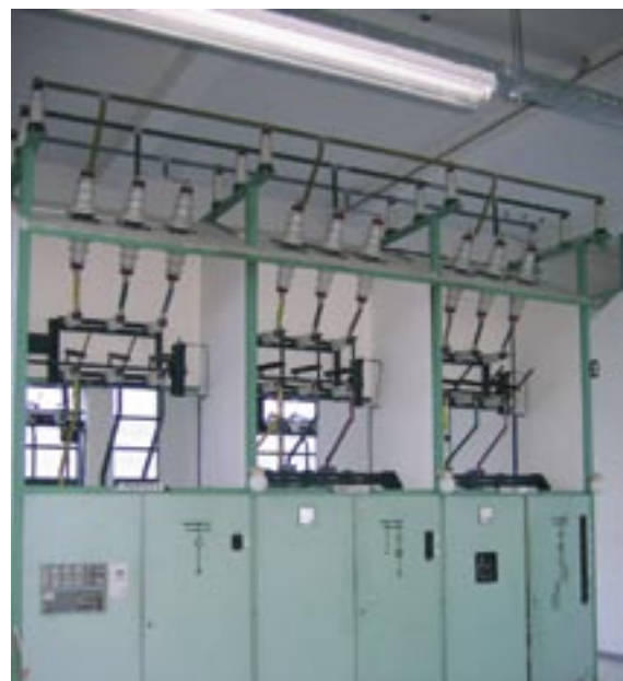
Slika 3: Obstoječe stikališče 35 kV.
