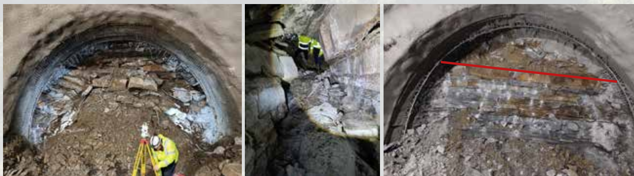
Slika 3: Levo: čelo predora znotraj plazu; sredina: »kaverna« v GC na metru 54,7; desno: čelo v GC pretežno že zunaj območja plazu
