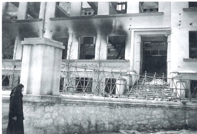
7. Uničeno pročelje ljudske šole
