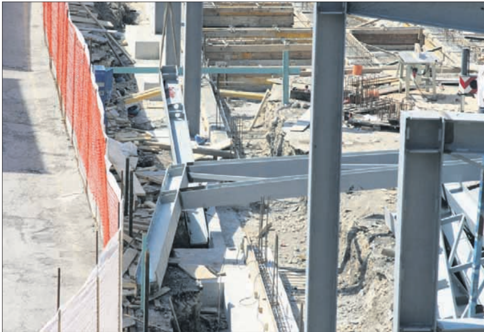
Steber je pod seboj dobesedno pokopal delavca.
