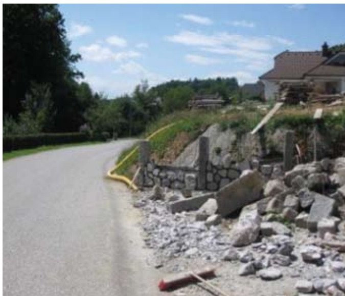
Gradnja v varovalnem pasu občinske ceste brez soglasja upravljavca ter zavarovanja del.
