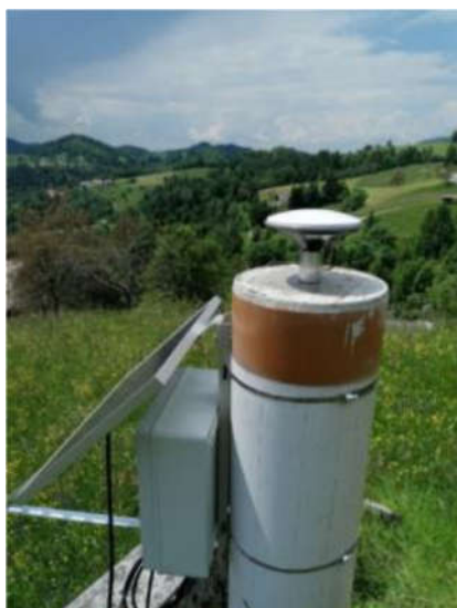
Slika 13. Steber ST I in inštaliran cenovno ugoden GNSS-monitoring sistem za beleženje in shranjevanje opazovanj GNSS
