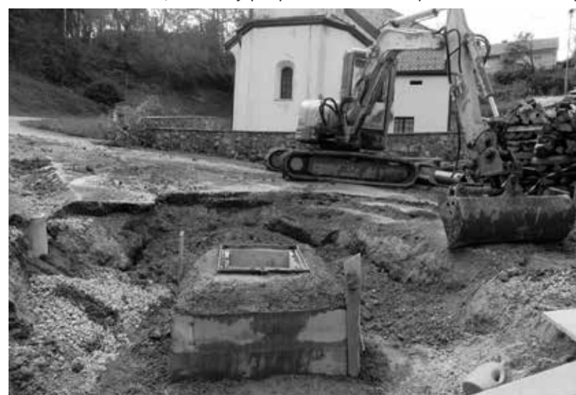
Metnaja, sanacija udora ceste in vaškega vodnjaka
