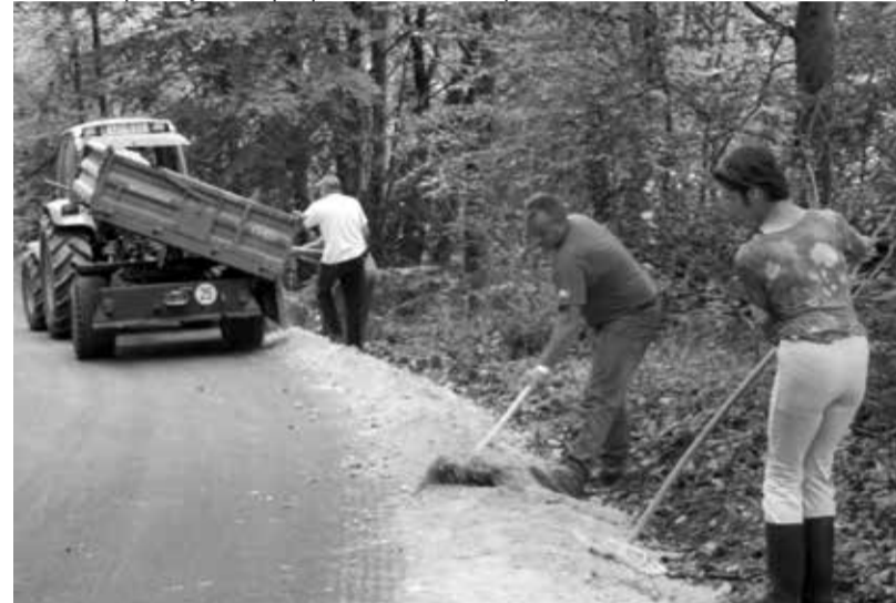
Obolno, obsipanje bankine po preplastitvi dela ceste
