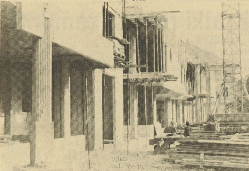
Gradnja novega trgovsko-poslovnega centra in avtobusne postaje v Rogaški poteka po načrtih (foto Z. Novak).
