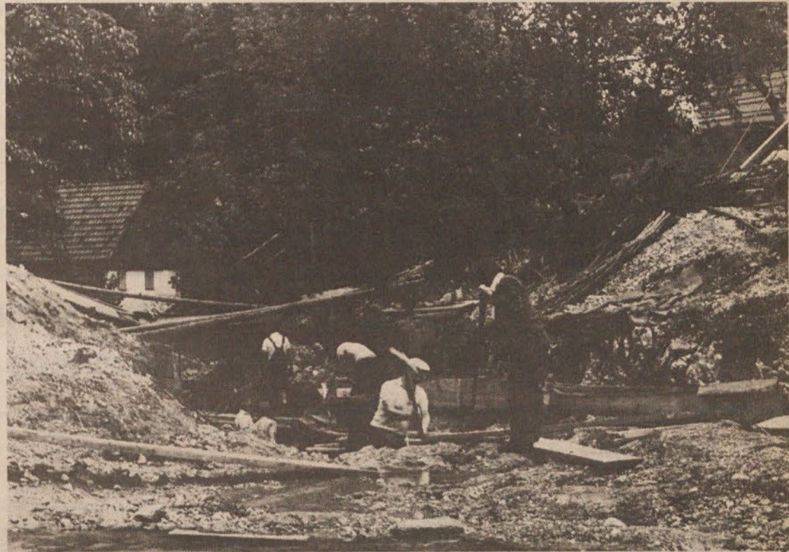
Občani so s prostovoljnim delom prispevali k hitrejši izgradnji nujno potrebnega vodovodnega omrežja
