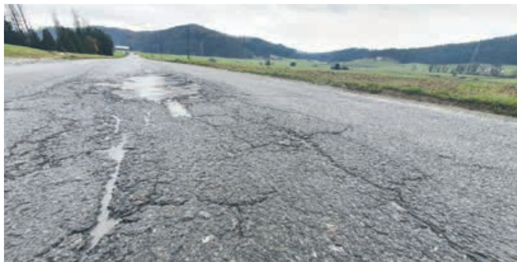
Razpoke in udarne jame na cesti med Podolnico in Brezjami.
